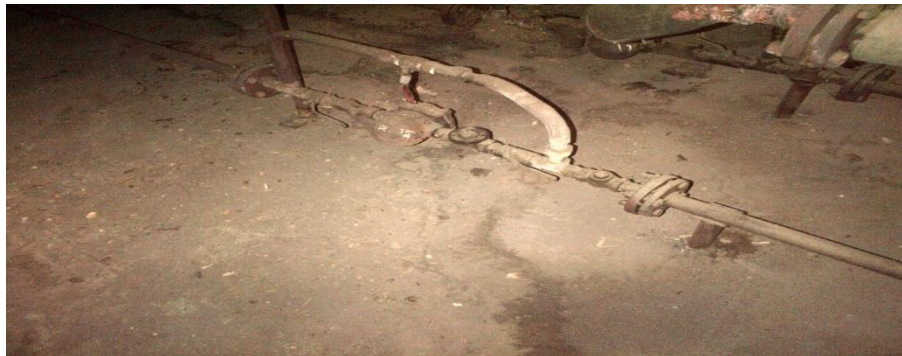
Hình 3.4: Đường ống hơi bị rò rỉ hơi
